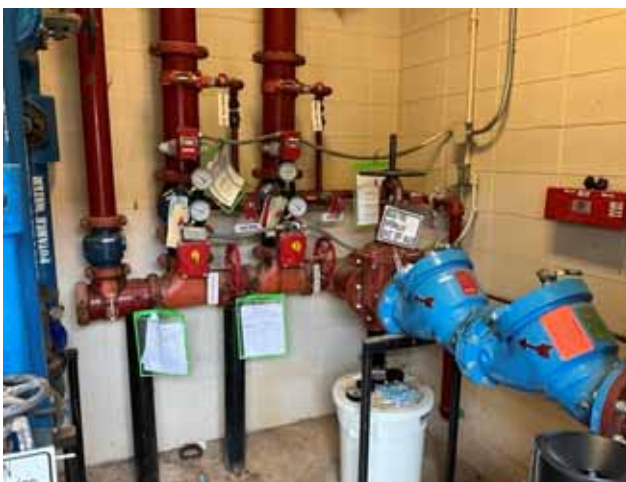
23 - FIRE SPRINKLER RISERS
